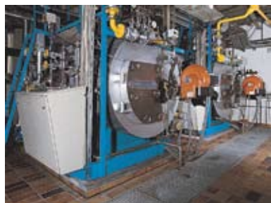
Виброизоляция теплового котла
